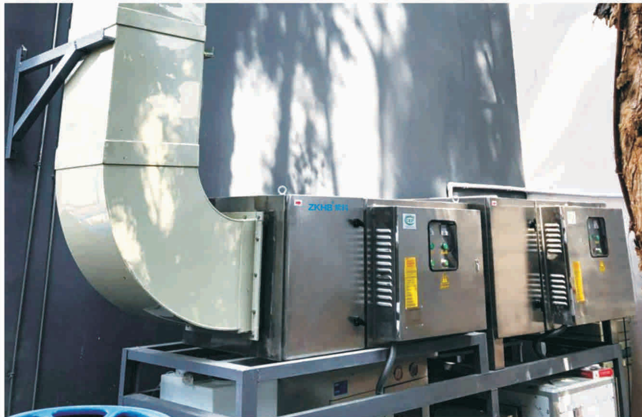
注：垃圾中转站除臭设备
