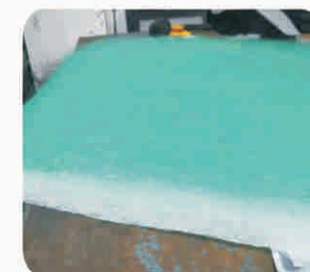
进风口漆雾沾过滤棉
